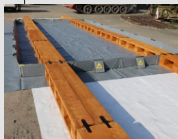
Záchytná vana s dřevěnými nájezdovými rampami
