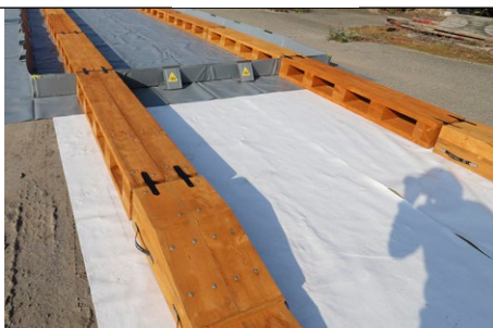
Záchytná vana s dřevěnými nájezdovými rampami
